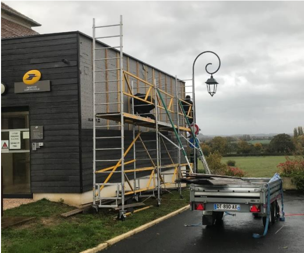
Changement d'une partie du bardage de l'agence postale suite à une anomalie de la structure du bois (garantie décennale)
